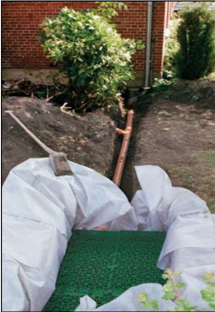
Figur 11. Dagvattenkassetter för fördröjning av takdagvatten (Foto: Norconsult)
